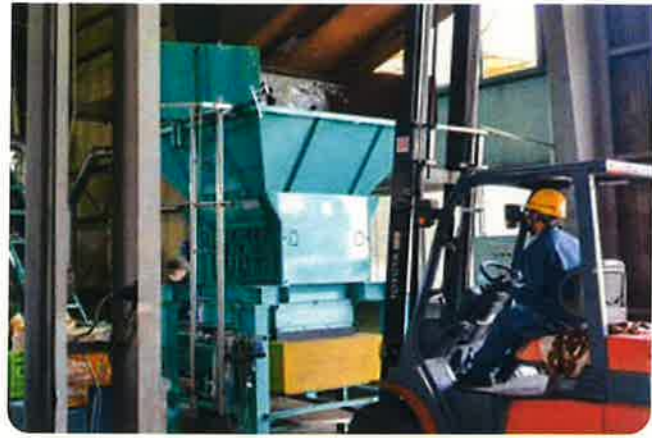
ペットボトルの塊を開梱機に投入すれば、ラベル剥離機、粉碎機へと自動で流れていく。
