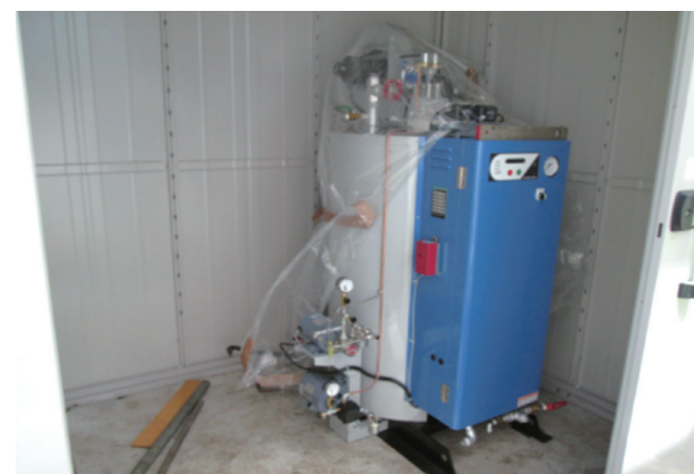
ボイラー設備
