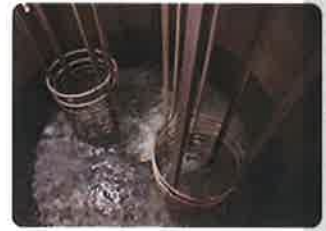
冷却タンクの内部。自動冷却装置により外気温に関係なく原酒の温度をコントロールできます。
